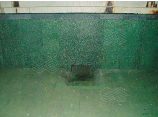
Chromkorund-Durchlass in einer neugebauten Faserglaswanne / Chrome corundum throat area in a rebuilt fiber glass furnace
